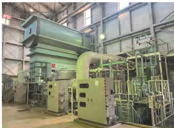
図5 蒸気タービン及び発電機
